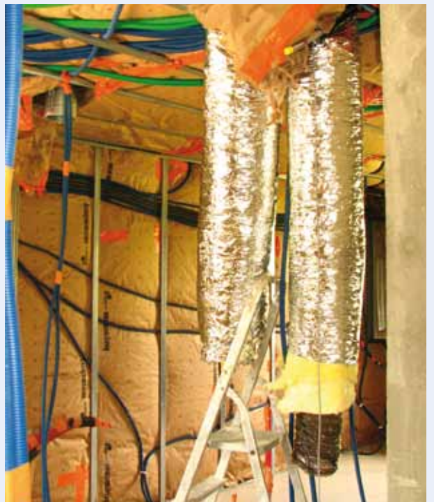
11 . Conduits principaux de soufflage et de reprise, en attente de l'échangeur
