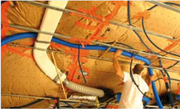
7 . Départ du réseau Minigaine pour l'insufflation en salon
