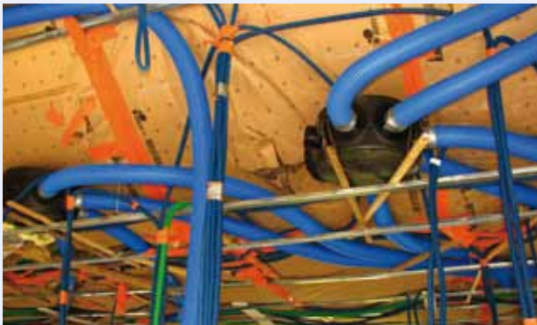
9 . Caissons de soufflage et d'extraction en attente de raccordement à l'échangeur
