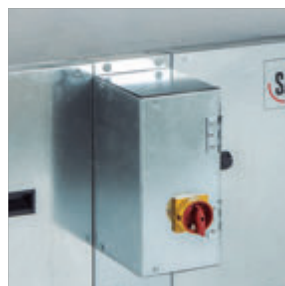
Armoire électrique intégrée
