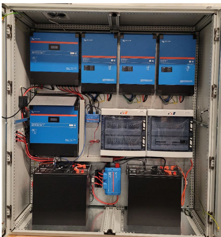
Figure 58 : Modèle 3x5 kVA, 4x3,55 kWh de stockage
