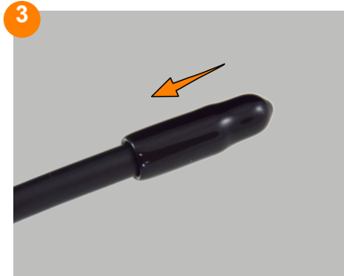
3 Une fois le câble tiré dans le regard et en attente de son raccordement au point de démarcation, couper la boucle de tirage du câble et poser le capuchon de protection.
