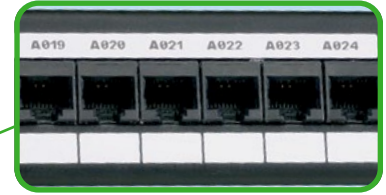
Panel de conexiones / Etiquetas de placa de pared
