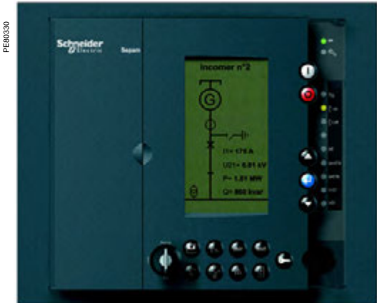
Commande locale à partir de l'IHM synoptique.
