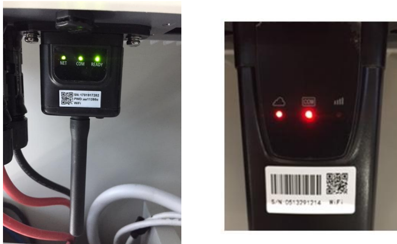
Figure 39 – État final des led
