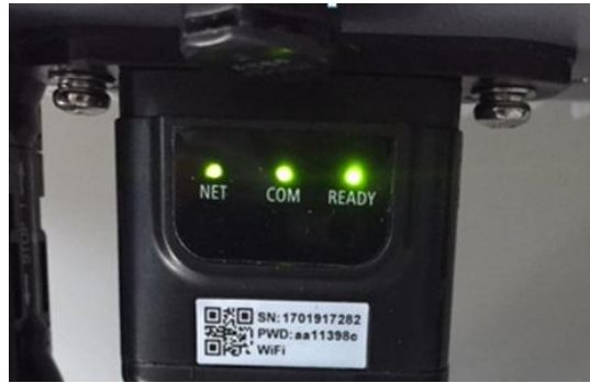
Figure 57 – État final des led
