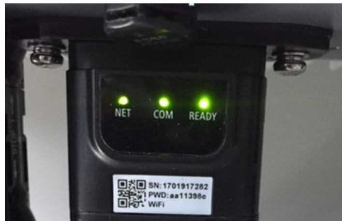
Figure 51 - État final des led
