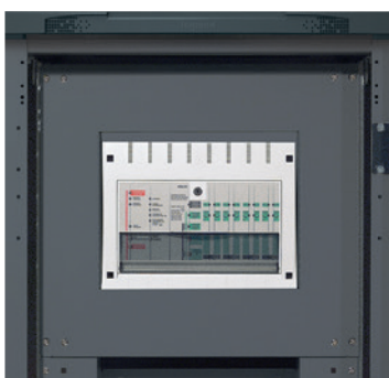
0 406 50 sans 0 406 52 dans une baie LCS 2
