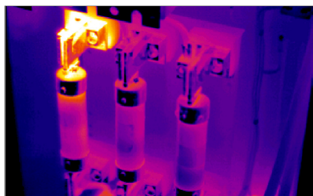
Contrôle d'armoires électriques
