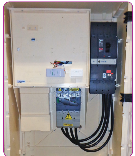
Exemple d'équipement intérieur : coffret BPS 400A avec sectionnement + disjoncteur (AGCP)
