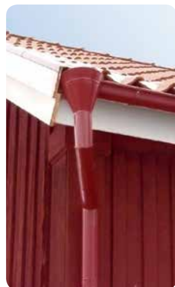
Tradition. Takavvattning som smälter in i husets arkitektur.
