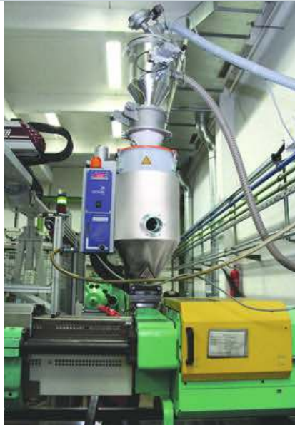
Bild 6. Sicherheitshalber hat Hillers auf den Maschinen zuschaltbare Aufsatztrockner installiert, um das Rückfeuchten des Granulats in der Materialvorlage zu verhindern
