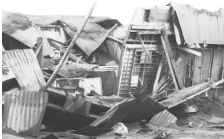
Voilà tout ce qui reste du centre de santé de Rabaul en Papouasie Nouvelle Guinée.
