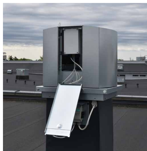
Alla styrdon är integrerade inuti takfläkten bakom en skyddslucka.
