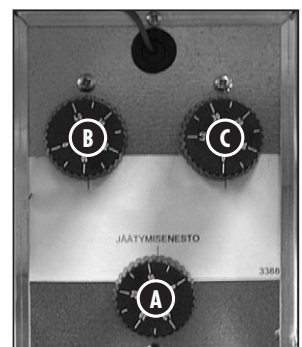
Termostater (bakom täckplåten)
