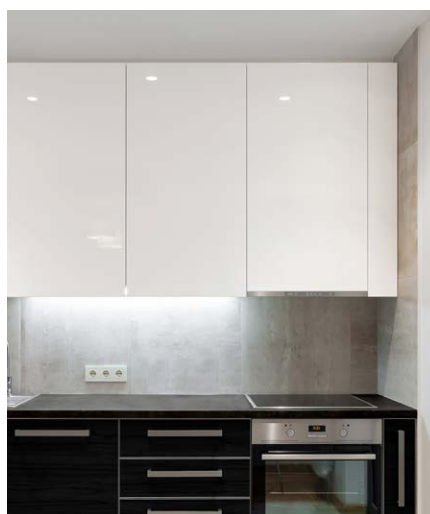
MyVallox 51 K CFi on asennettu keittiökaapistoon liedin päälle, jossa se on tyylikkäästi poissa silmistä.
