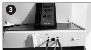
Mät spänningen vid polerna – och S, och ställ t.ex. in hastighet 1 vid potentiometer 1.
