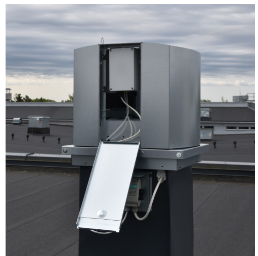
Alla styrdon är integrerade inuti takfläkten bakom en skyddslucka.
