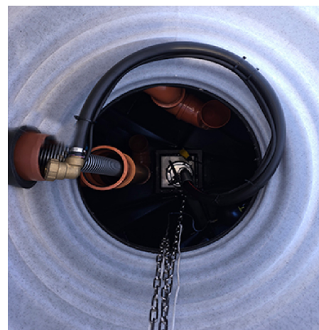
Pumpeslange i opføringsrør
