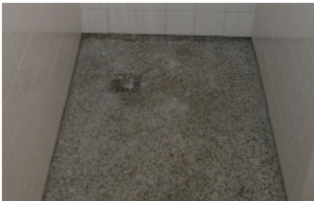
Kalkaanslag op de vloer
