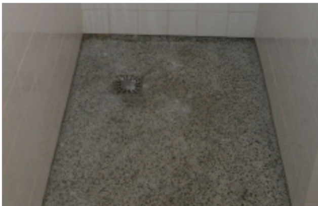
Kalkaanslag op de vloer
