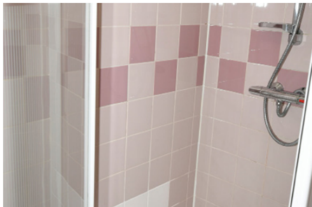
Kleurverschil in de tegels en voegwerk
