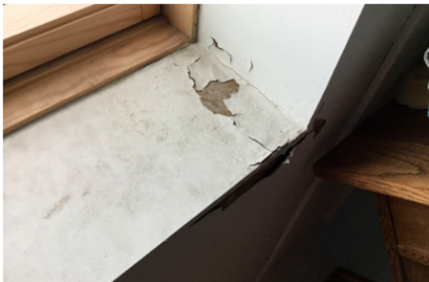
Houtwerk beschadigd door vocht (herstelschade)
