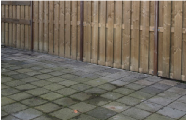
Verkleuringen in tegels
