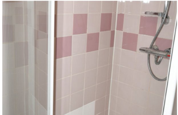
Kleurverschil in de tegels en voegwerk
