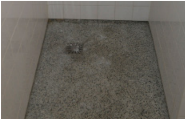
Kalkaanslag op de vloer
