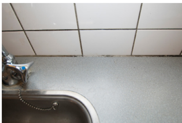
Schimmel in kitvoegen
