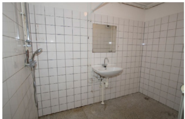
Badkamer niet goed schoongemaakt
