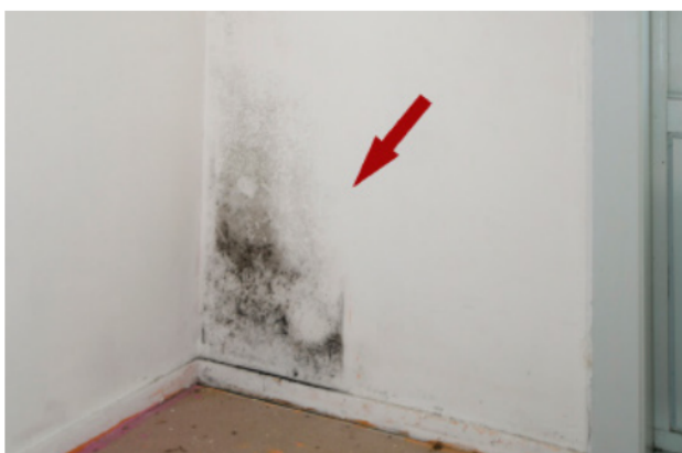
Schimmel op de muur
