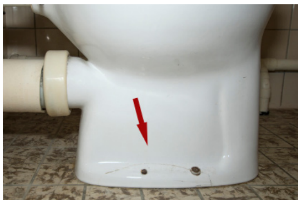
Scheur in toilet
