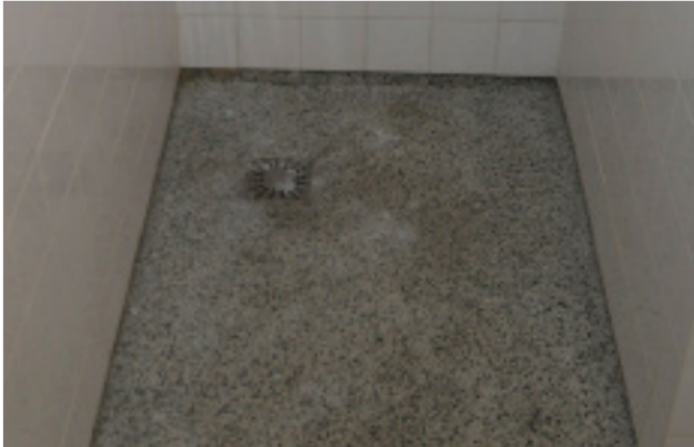
Kalkaanslag op de vloer
