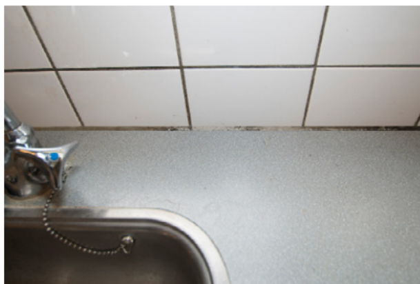
Schimmel in kitvoegen
