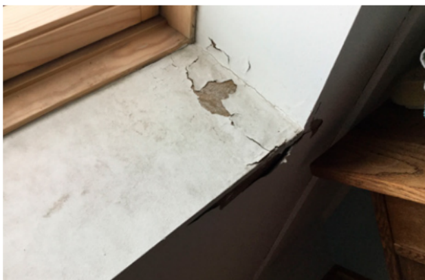
Houtwerk beschadigd door vocht (herstelschade)
