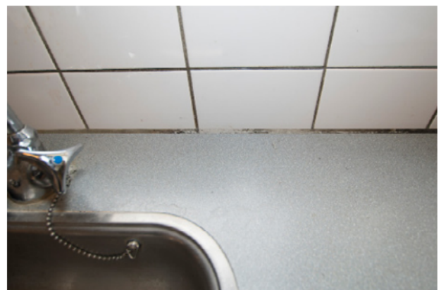
Schimmel in kitvoegen
