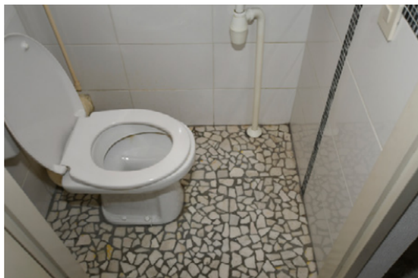
Tegelwerk niet standaard
