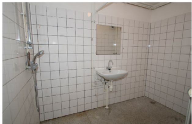
Badkamer niet goed schoongemaakt
