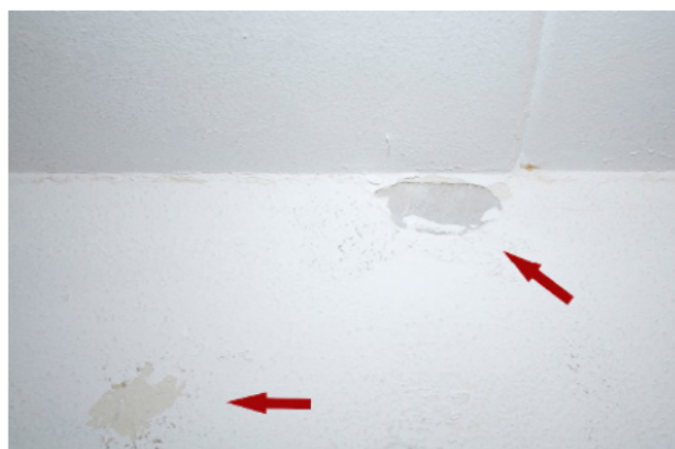
Verf of stucwerk laat los
