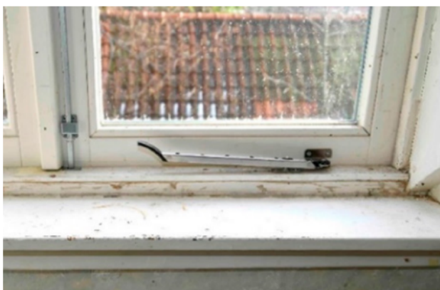
Onderkant van kozijn aangetast door vocht
