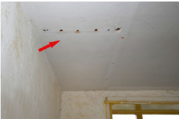
Gaten in het plafond
