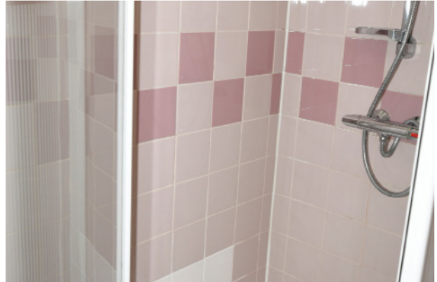
Kleurverschil in de tegels en voegwerk
