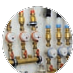
Счетчики расхода холодной и горячей воды
