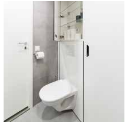
Seinään kiinnitetty wc-istuin.
