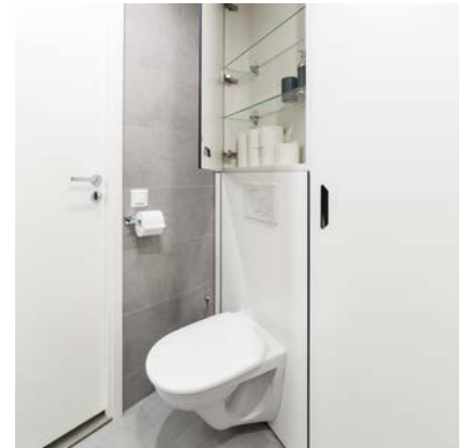
Seinään kiinnitetty wc-istuin.
