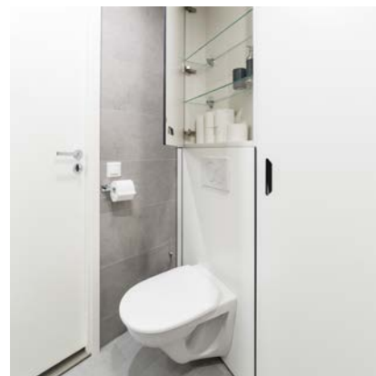
Seinään kiinnitetty wc-istuin.
