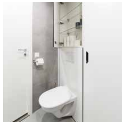
Seinään kiinnitetty wc-istuin.
